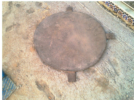
TAPA PROVISIONAL POZOS
